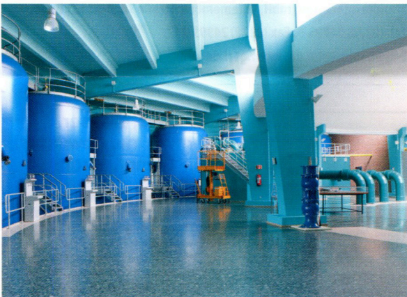
In Deutschland sorgen 25000 Vertikalfilterbrunnen für die Versorgung mit frischem Wasser.
