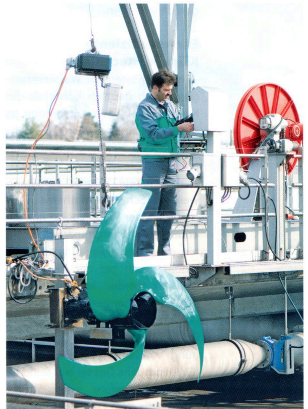
Mit modernen IE3-Motoren ausgestattete langsam laufende Tauchmotorrührwerke mit optimierter Flügelgeometrie bergen ein erhebliches Potenzial zur Energieeinsparung in Klärbetrieben. © WILO SE
