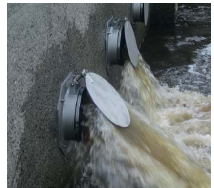
Froschklappen am Pumpwerk zur Abgabe des abgepumpten Wassers in den Fluss.
