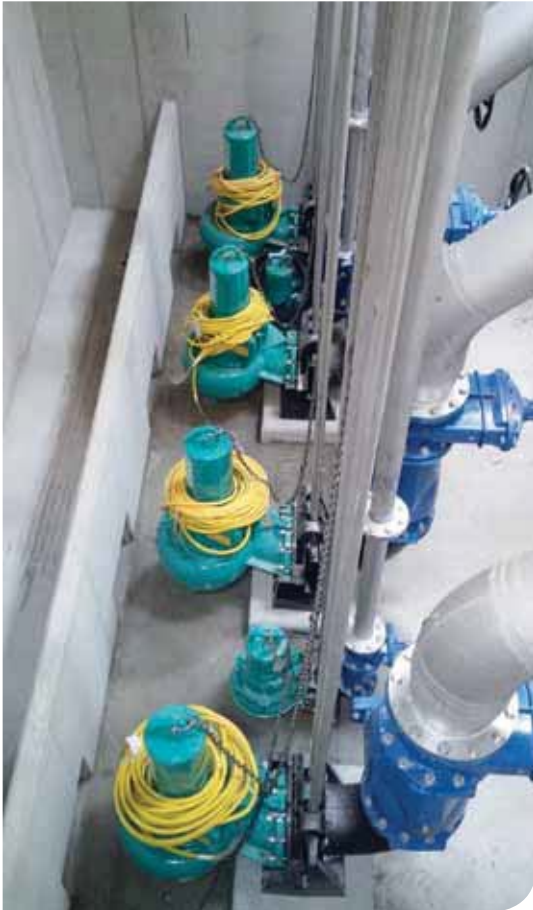
Montierte Pumpentechnik mit Druckleitung und Armaturen.
