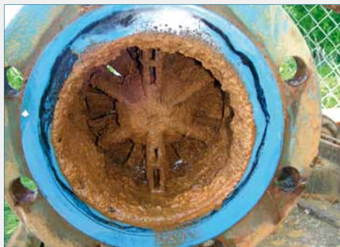
Abb. 4: Durch das Zusetzen von z. B. Filterstrecke und Steigleitung arbeiten selbst korrekt ausgelegte und funktionierende Pumpen nicht mehr im Bestpunkt. Die Pumpen laufen in den Teillastbereich und arbeiten dadurch länger bei schlechterem Wirkungsgrad mit erheblichen Auswirkungen auf die Betriebskosten.
