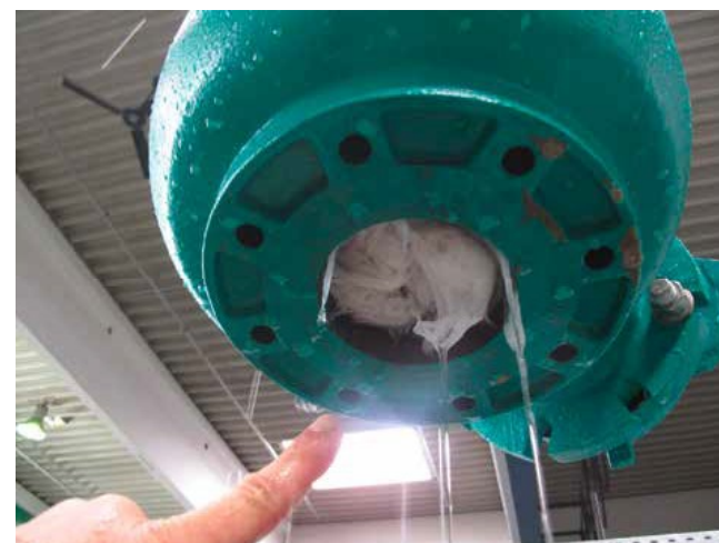
Bild 1 Die handelsüblichen Feuchttücher verstopfen die Pumpe. Quelle: Wilo SE
