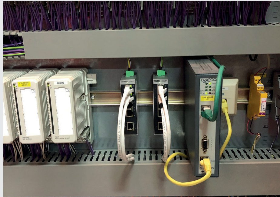
Bild 4 Die Ethernet-Schnittstelle wird mit den Anschlüssen im Schaltschrank verbunden. Quelle: Wilo
