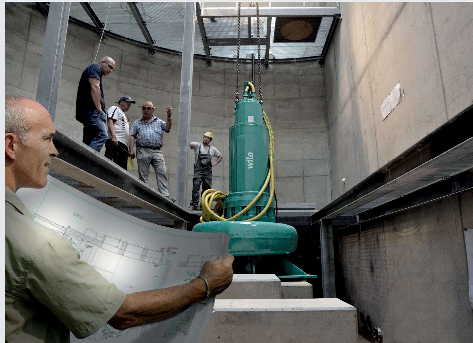
Bild 1 Das Pumpwerk im Gewerbegebiet Pforzheim-Buchbusch wurde komplett mit Wilo-Pumpen ausgestattet.
