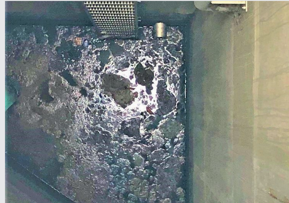
Bild 6 Das Abwasser wird problemlos aus dem Abwasserschacht gefördert. Quelle: Wilo
