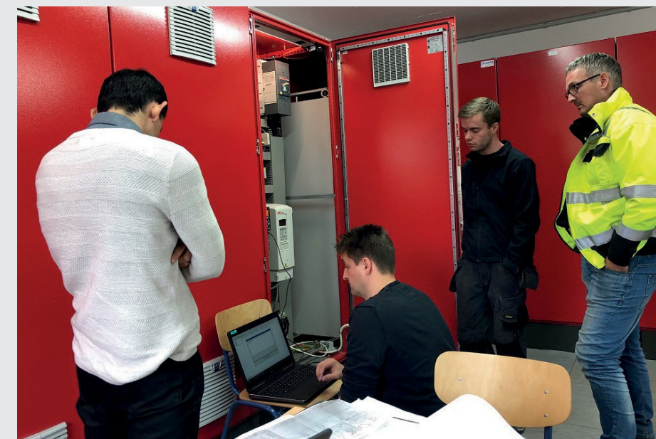
Bild 3 Die Pumpe wird mit dem System verbunden. Quelle: Wilo
