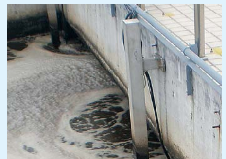
TRW im Belüfterfeld
