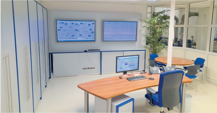
Bild 2 Die detaillierte Überwachung von Pumpen ermöglicht Rückschlüsse hinsichtlich Laufverhalten, Temperatur und Energieeffizienz.
