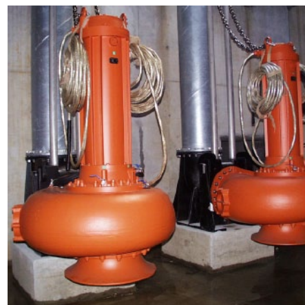
Einbaulage der FA-Abwasserpumpen, installiert auf Einhängenvorrichtungen mit Zweirohrführung.
