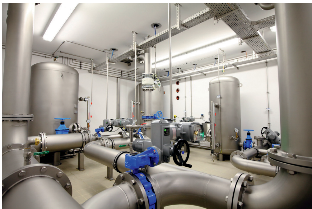
Bild 1 Wasserwerk Cham: Saug- und Druckrohrleitungen und Druckbehälter
