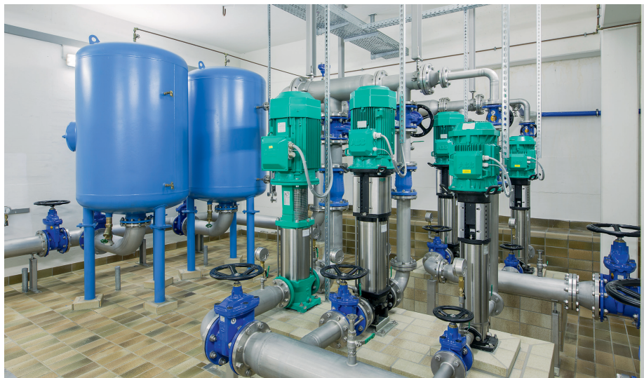
Bild 8 Die modernisierte Anlage mit den Druckbehältern
