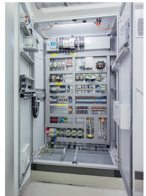
Bild 7 Blick ins Innere des Schaltschranks
